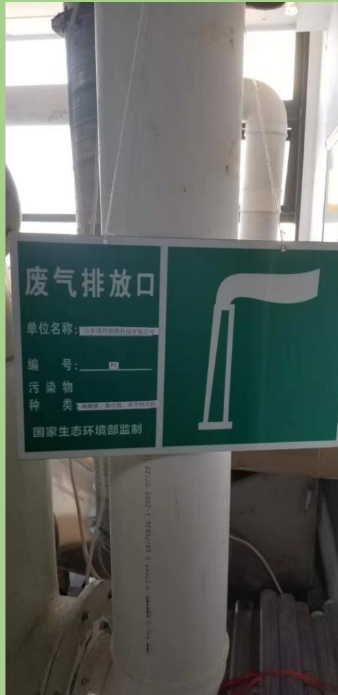
废气排气筒标识牌
