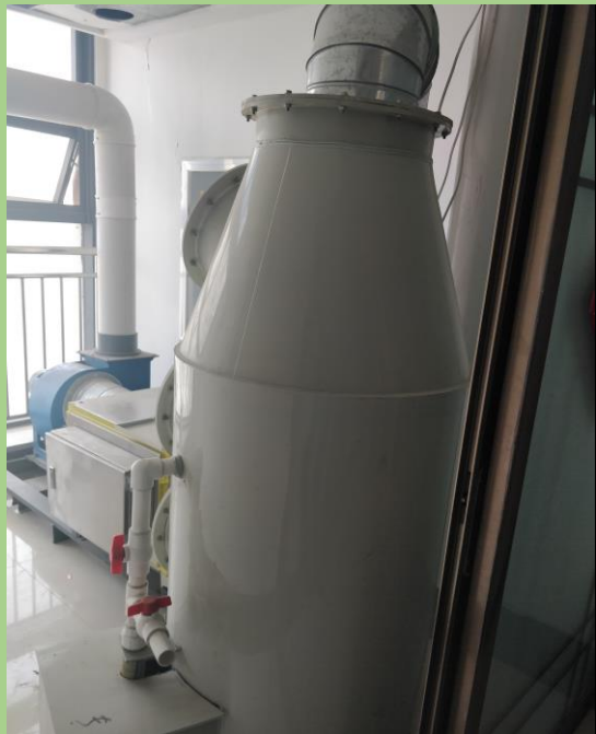
碱液喷淋+UV 光氧化装置
